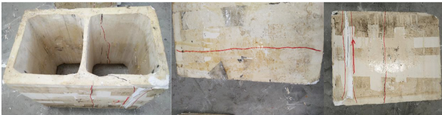
Cracked segment of lining structure (10#) (d)
